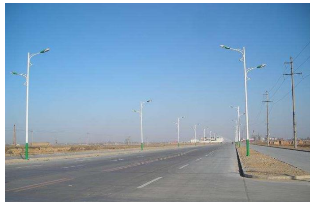
常见道路照明
